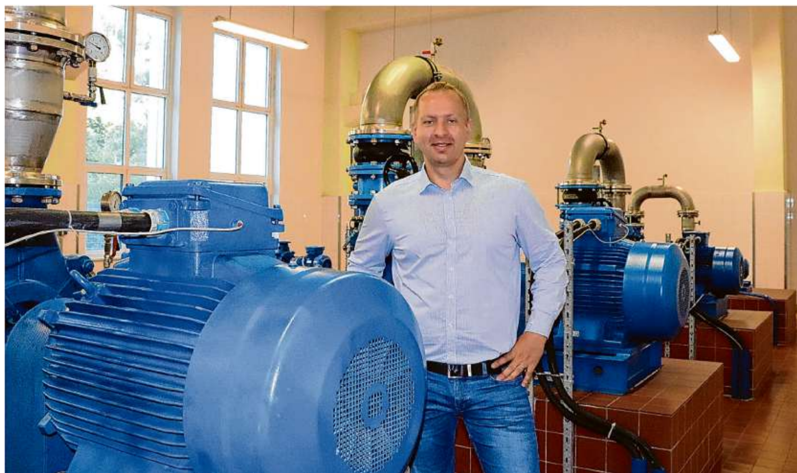
Sorgt sich um die Belastung der Pumpen: Thomas Schönbeck, der neue Technische Leiter des Wasserverbandes Strausberg-Erkner, im Wasserverswerk Strausberg Foto: Sandra Ponesky
