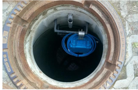
Datenlogger im Schmutzwasserschacht
