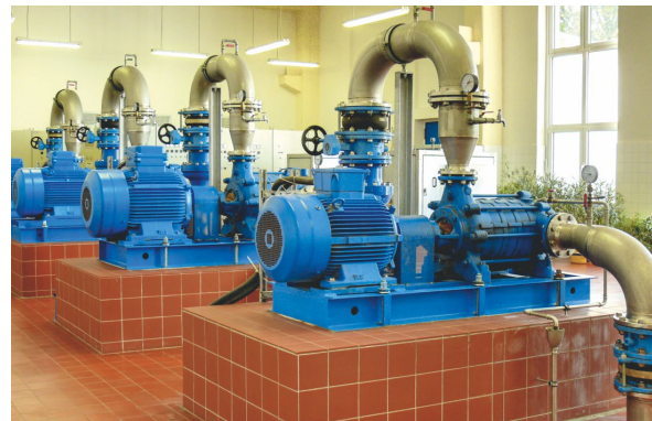
Abbildung: Innenansicht Wasserwerk Strausberg
