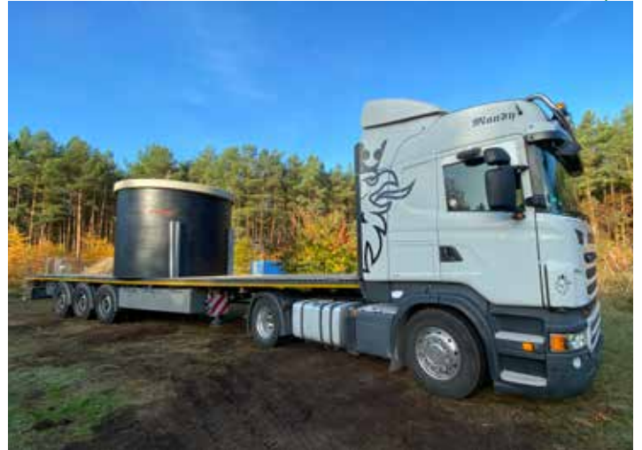
10) Auf einer anderen Baustelle ganz in der Nähe ist ein neuer Brunnen bereit fertig gebohrt. Per LKW wurde die 13 Tonnen schwere Brunnenstube aus einem Betonwerk in Nordhausen angeliefert. Sie ist das Abschlussbauwerk, das über den gebohrten Brunnen gesetzt wird.
